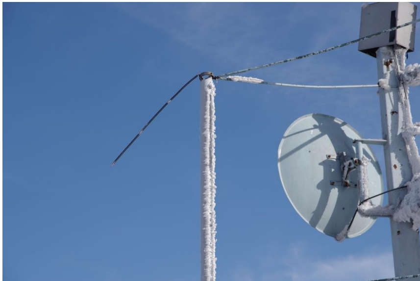
Die abgeknickte Antenne - Foto: DO5UH
