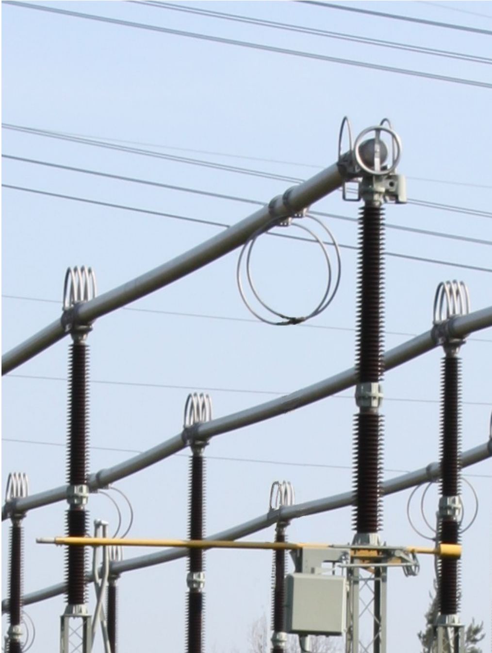
Bild 1: Sammelschienenerder (die gelbe Stange) in einer 380kV Freiluftanlage
