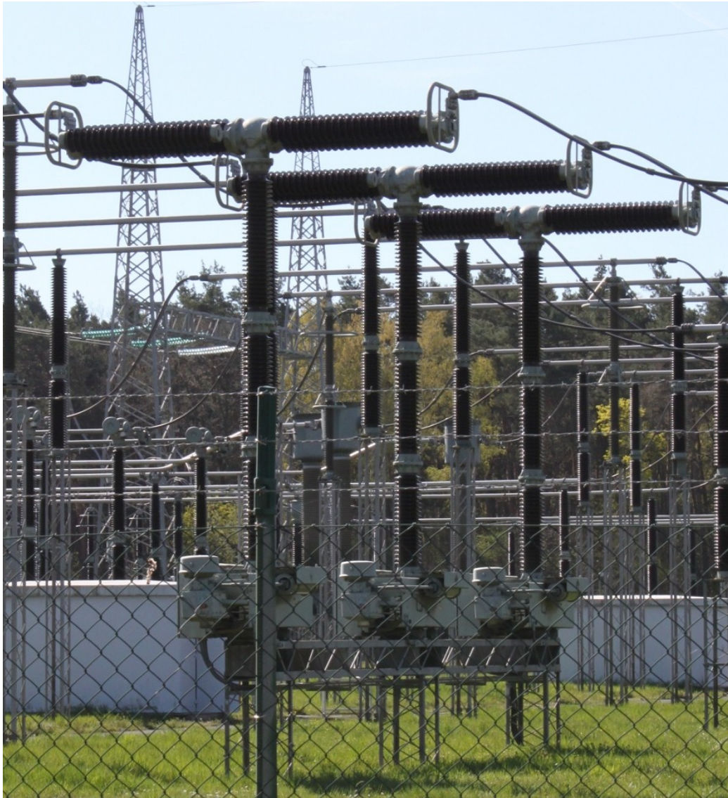
Bild 4: Leistungsschalter in einer 380kV Anlage
