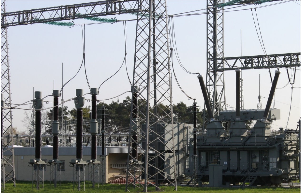
Bild 11: 380kV / 110kV Transformator, links davon stehen die Wandler für die Messung der überspannungsseitigen Spannungen und Ströme
