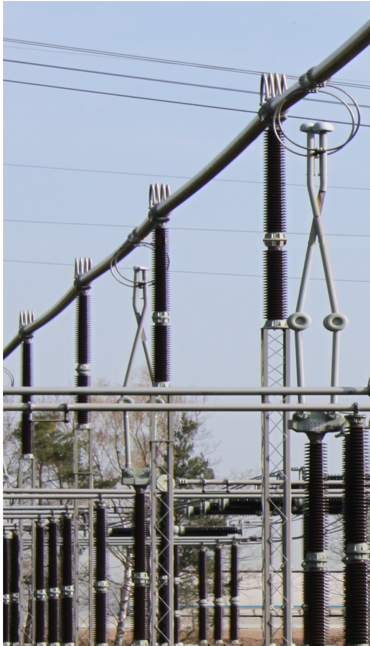
Bild 2: Sammelschienenentrenner in einer 380kV Freiluftanlage
