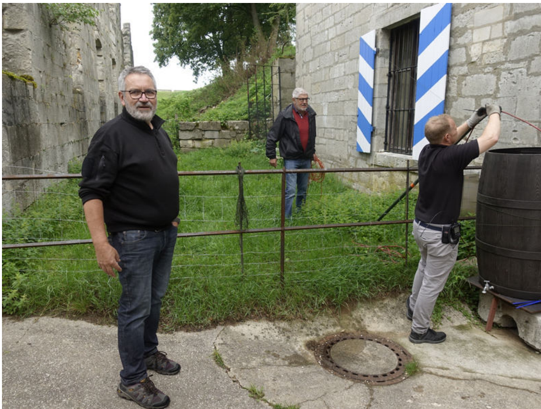
Kabelverlegung zur Bastion Amalie; hier befindet sich die QO100 Satellitenstation
