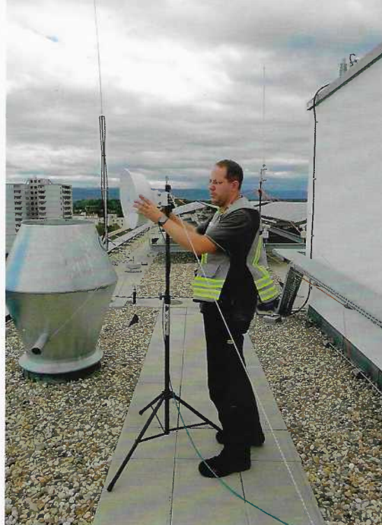
Abb. 2: Ausrichten einer AREDN-Antenne für optimale Leistung auf einer Ad-hoc-Richtfunkstrecke
