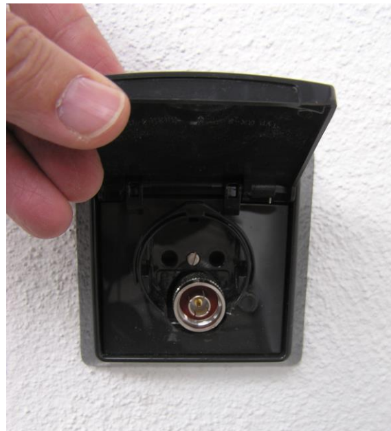
Bild 1b: Modifizierte Außensteckdose mit Abdeckklappe an der in Bild 1a markierten Position. Zu sehen ist das in den Kriechspeicher zurück geschobene Speisekabel mit dem N-Stecker
