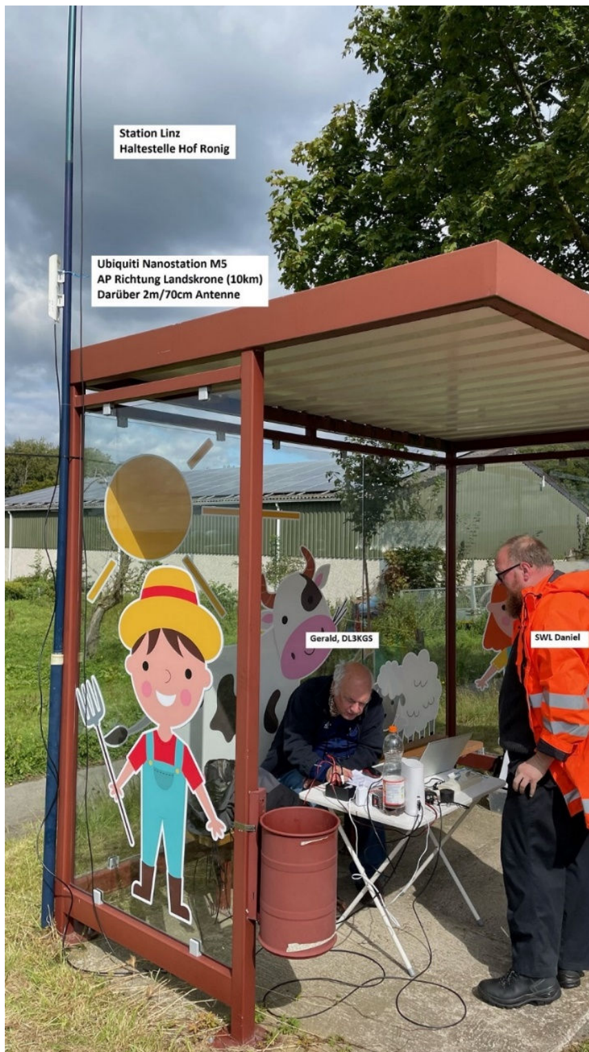
Einspeisung 4G-Mobilfunkversorgung in Linz
