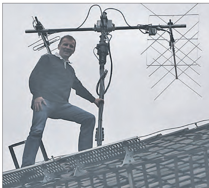
Die Antennen auf dem Dach des Soltauer Gymnasiums sind installiert und funktionieren. Markus Müller vom Walsroder DARC-Ortsverband ist zufrieden. Foto: mk
